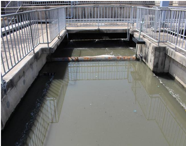
Hình 3.28. Bể lắng sơ cấp giai đoạn I
