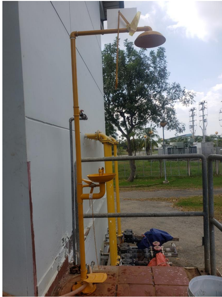
Hình 3.55. Vòi rửa mắt và tắm khăn cấp tại khu vực khử trùng của Nhà máy XLNT Bình Hưng
