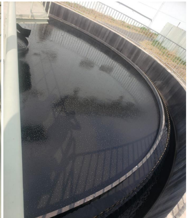
Bể cô đặc trọng lực Giai đoạn II
