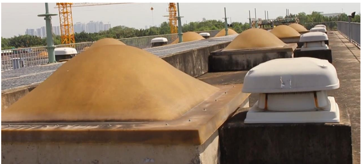
Hình 3.44. Hệ thống quạt hút mái
