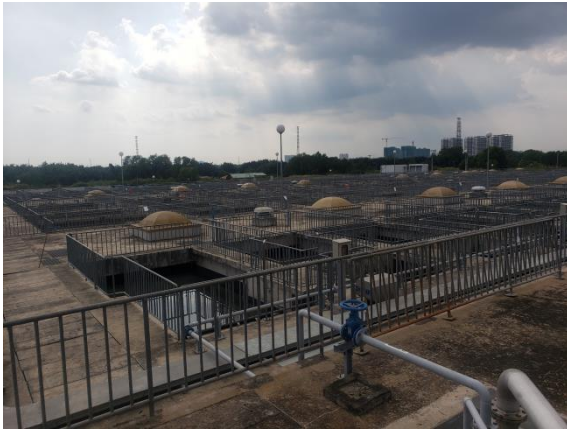
Hình 3.19. Khu cụm bể xử lý nước thải
