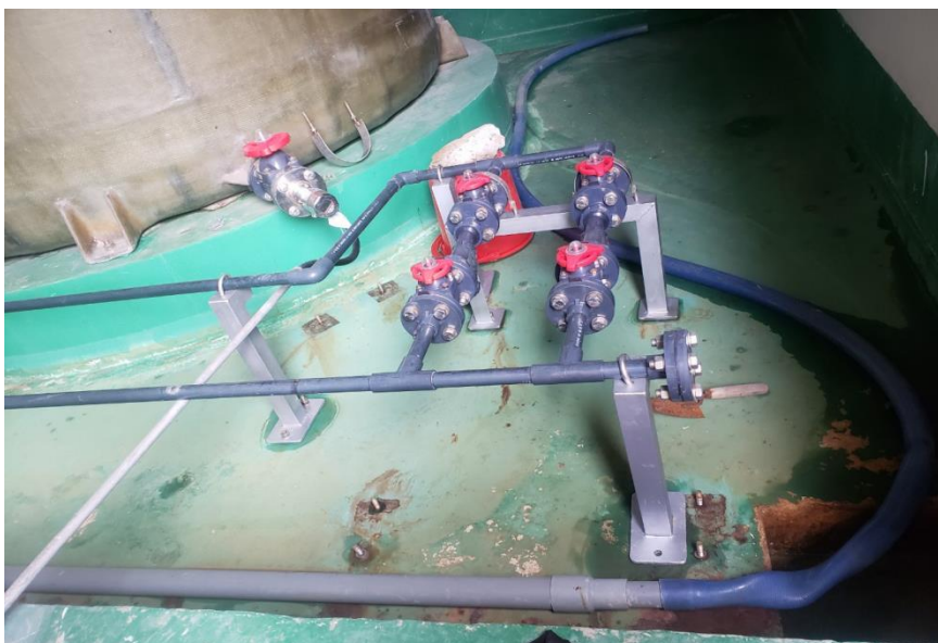
Hình 3.54. Hệ thống thu gom hóa chất chảy tràn tại khu đặt Javen khử trùng của Nhà máy XLNT Bình Hưng
