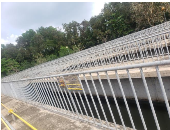
Bể khử trùng Giai đoạn II
