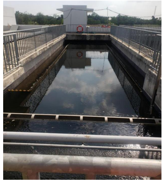
Hình 3.33. Bể lắng thứ cấp cụm bổ sung cho GD II
