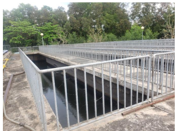
Bể khử trùng Giai đoạn I
