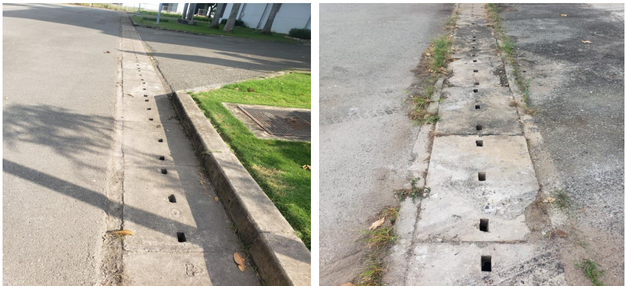
Hình 3.4. Hệ thống mương thu gom và thoát nước mưa của nhà máy XLNT Bình Hưng
