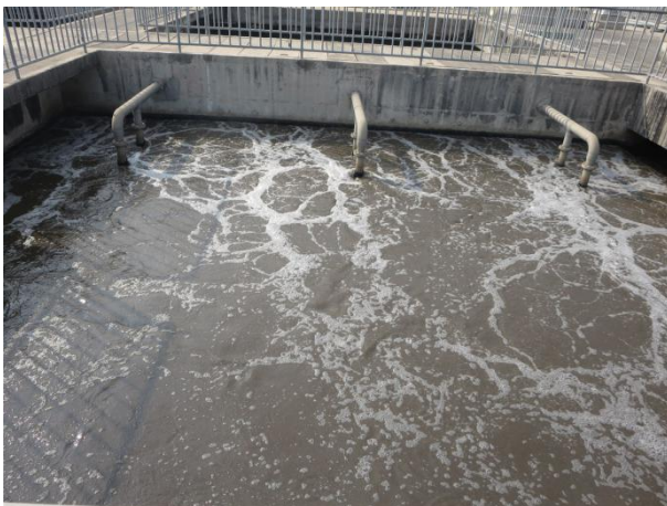
Hình 3.30. Bể sục khí giai đoạn I
