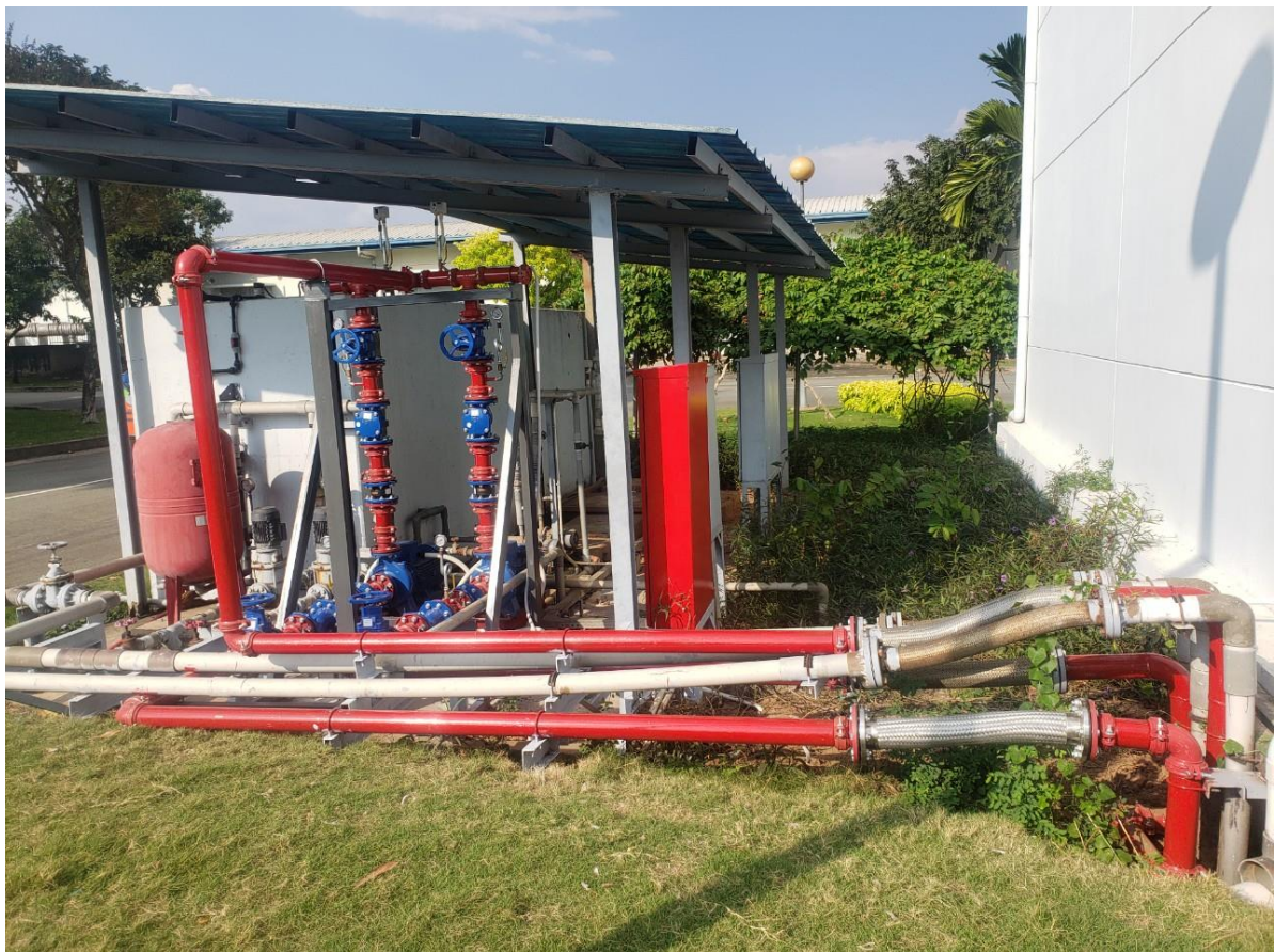
Hình 3.51. Trạm bơm nước PCCC tại Nhà máy XLNT Bình Hưng
