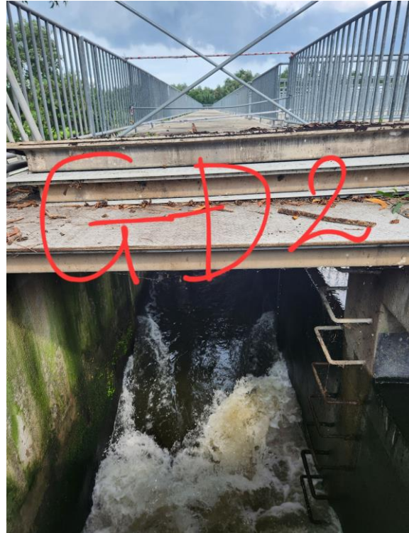
Hình 3.11. Mương thoát nước Giai đoạn II
