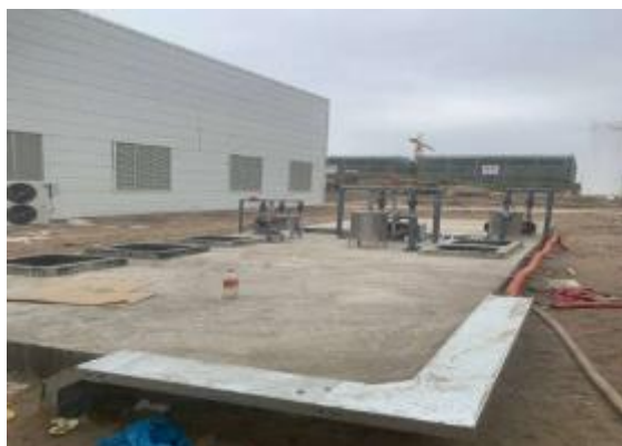
Khô bể gom nước thải công nghiệp
