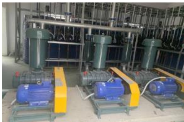
Hệ thống máy bơm
