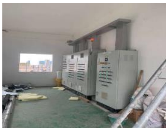
Khu vực bảng điều khiển Trạm XLNT
