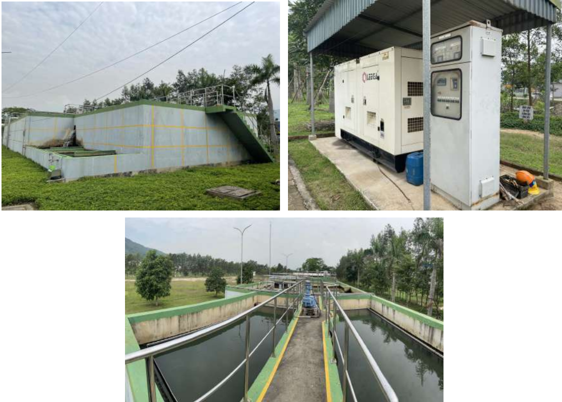
Hình 1. 3. Trạm XLNT tập trung của KCN công suất 1.100m 3 /ngày.đêm
