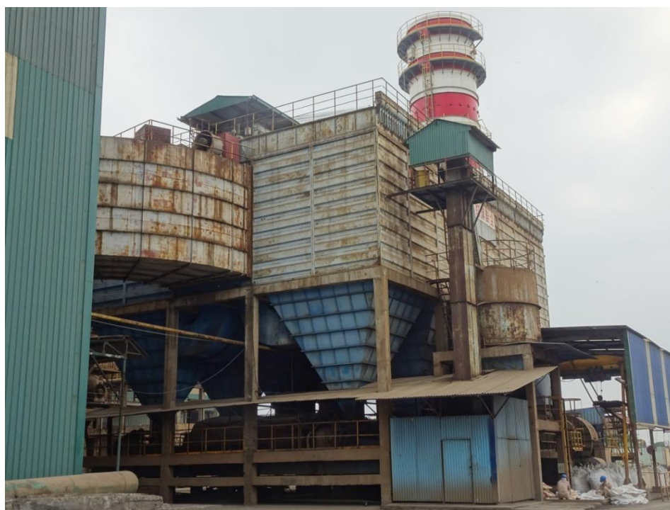
Hình 3.11. Bồn lọc bụi túi vải và ống khói Xưởng sản xuất phôi thép
