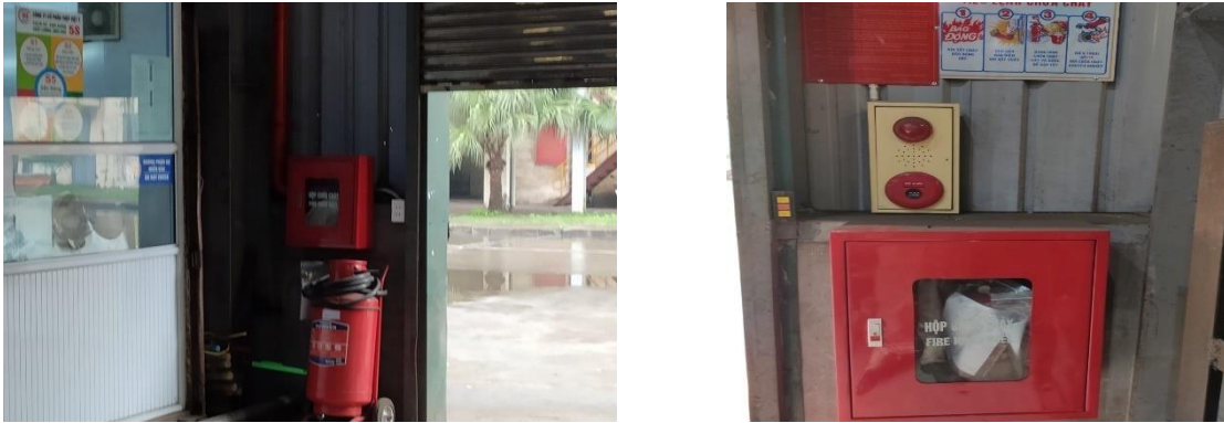
Hình 3.16. Một số hình ảnh hệ thống phòng cháy chữa cháy
