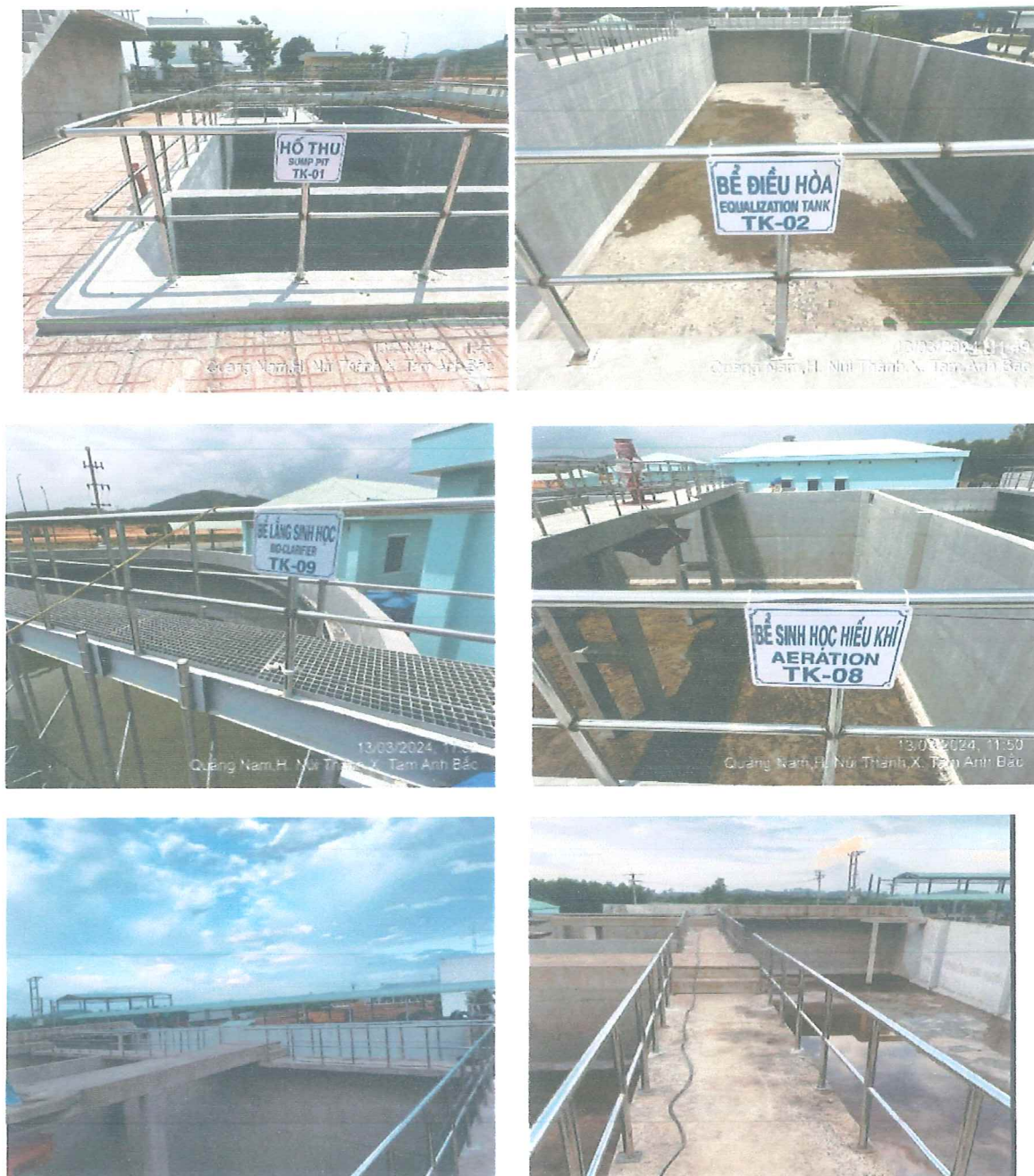
Hình 3.8. Hình ảnh Trạm XLNT tập trung của KCN
