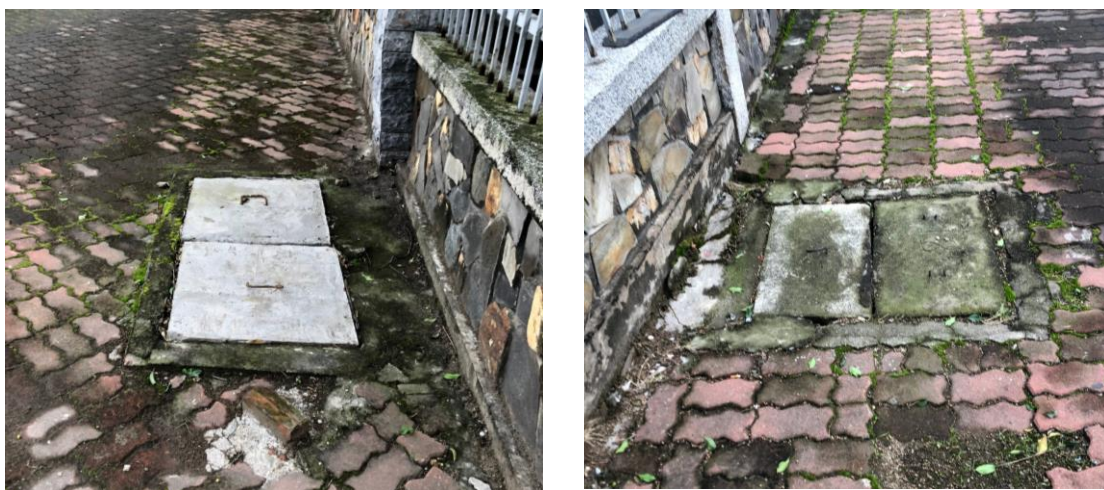
Hình 3.6. Hệ thống thu gom nước thải và ga thăm của KCN Hà Nội – Đài Tư
