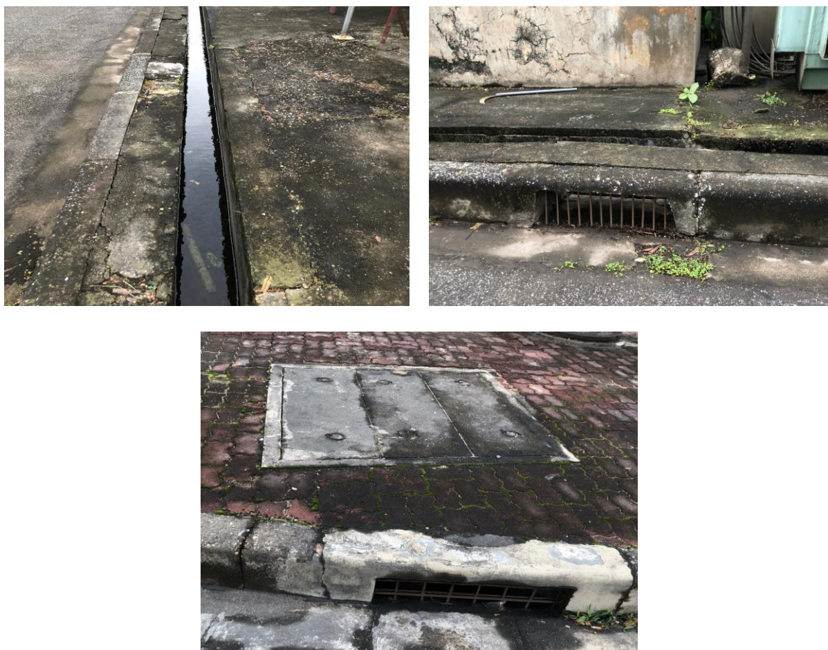
Hình 3.2. Hình ảnh kênh thoát nước mưa của khu công nghiệp
