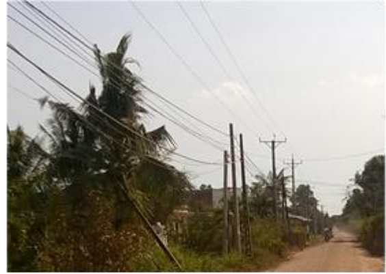
Tuyến trung thế 22KV hiện hữu chạy cặp theo Đường tỉnh 833B
