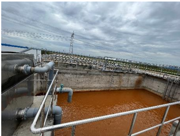
Bể điều hòa
