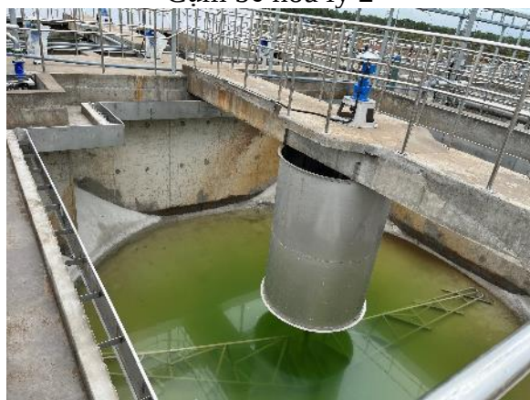
Bể lắng hóa lý
