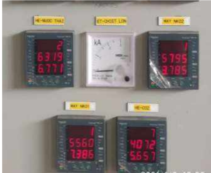
Hình 3.9 Công tơ điện của trạm XLNT
