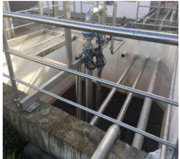
Bể thu gom
