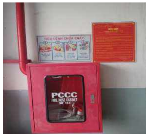
Tủ PCCC, tiêu lệnh, nội quy PCCC
