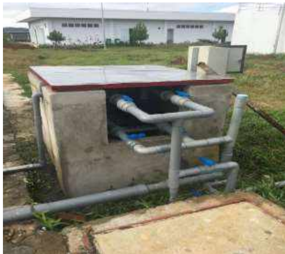
Trạm bơm tuần hoàn nước thải từ hồ sự cố về bể gom
