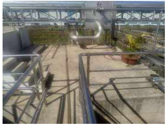
Bể nén bùn yếm khí
