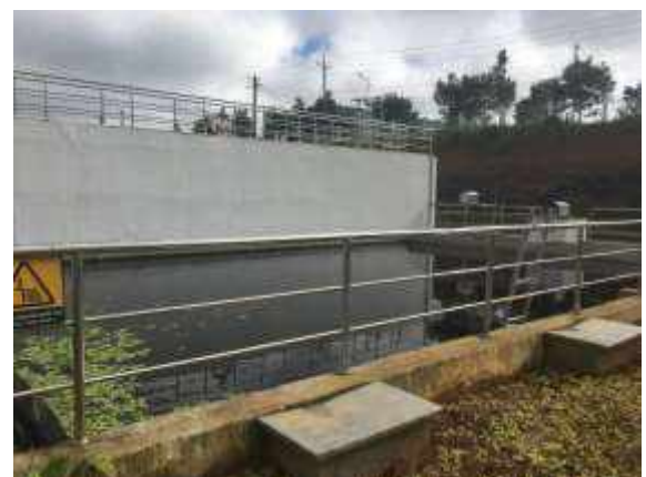
Bể xử lý Photpho
