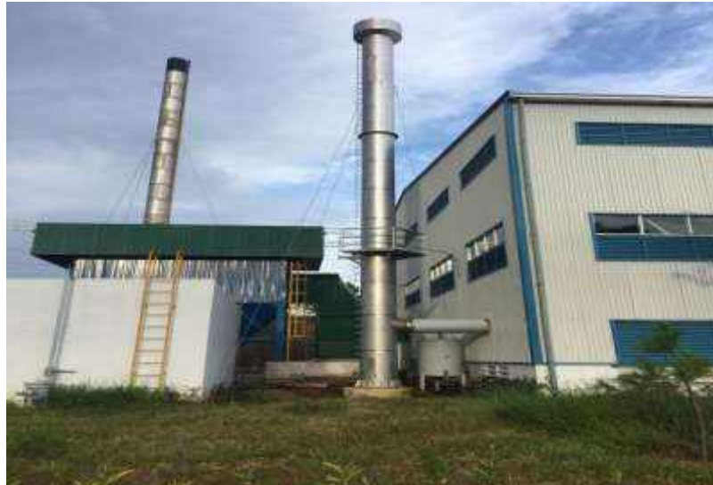
Hình 3.19 Hình ảnh lò hơi đốt dầu DO và hệ thống xử lý khí thải hiện hữu
