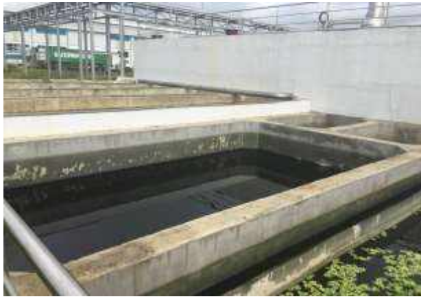
Bể khử trùng
