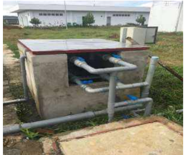
Trạm bơm tuần hoàn nước thải từ hồ sinh học kết hợp ứng phó sự cố về bể gom
