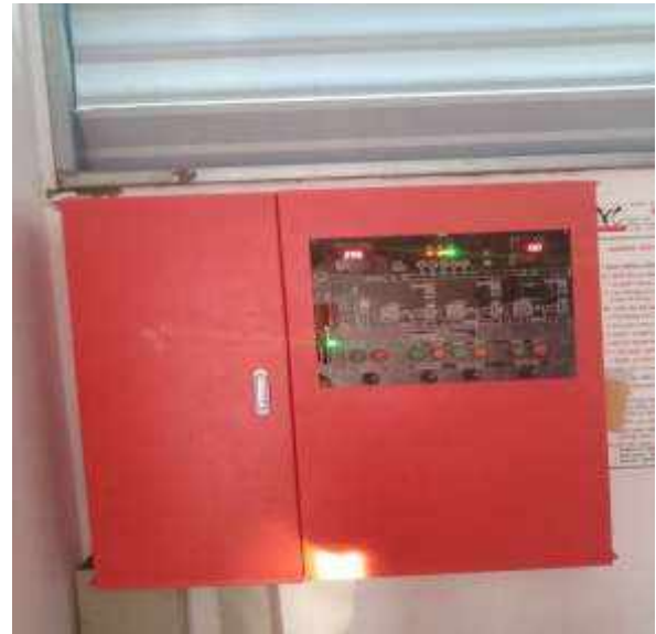
Tủ điều khiển bơm
