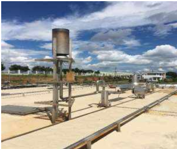
Bể UASB, bể lắng UASB và hệ thống đốt khí Biogas
