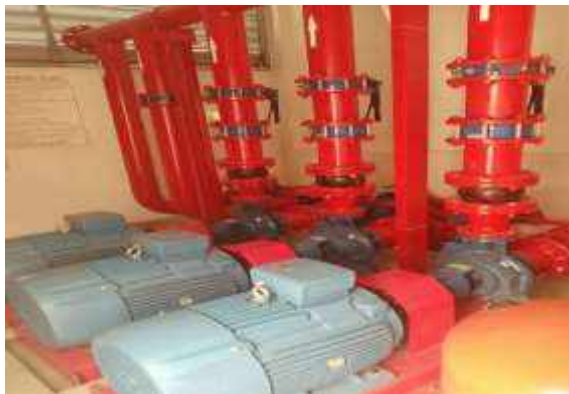
Bơm nước PCCC
