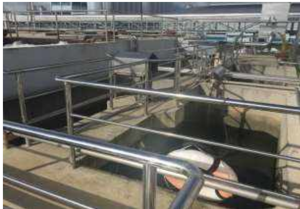
Bể nén bùn
