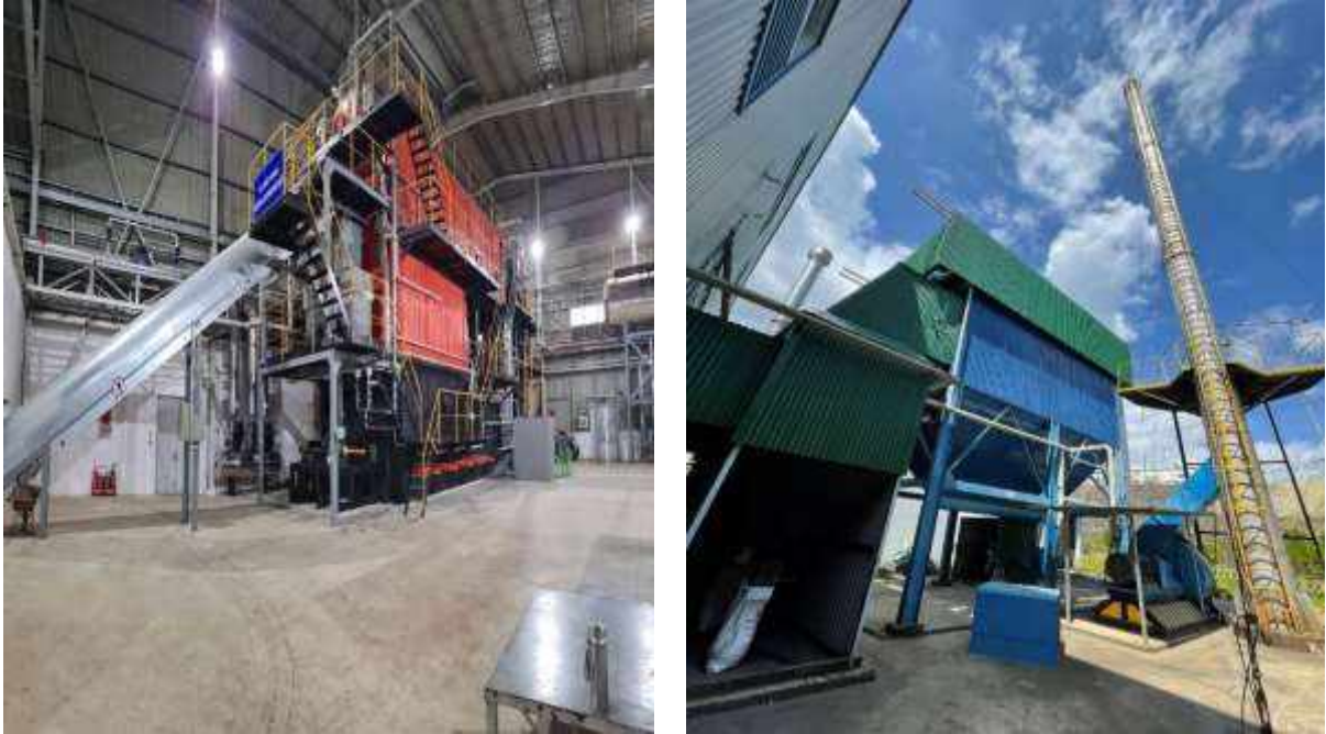
Hình 3.16 Hình ảnh lò hơi 16 tấn đốt biomass và hệ thống xử lý khí thải lò hơi hiện hữu
