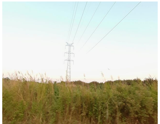
Đường điện 220kv
