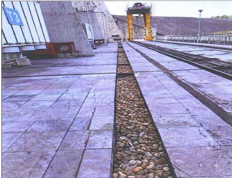
Hình 3.3. Rãnh thu gom nước mưa, dầu sự cố trạm biến áp (chụp ngày 25/7/2024).
