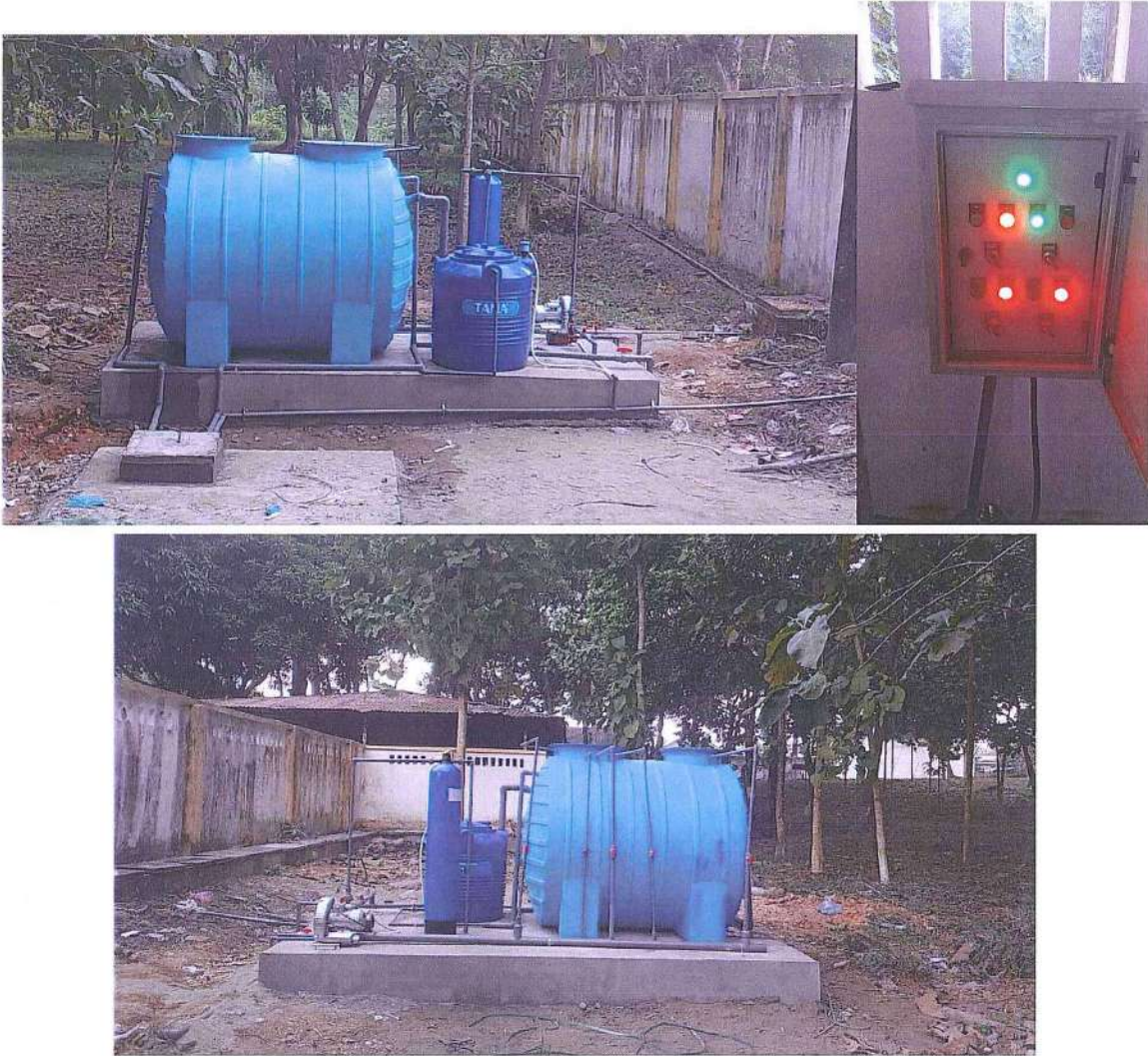
Hình 3.9. Ảnh chụp hệ thống xử lý nước thải hợp khối
