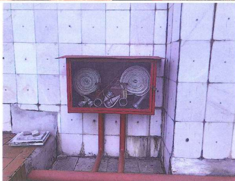
Hình 3.15. Hình ảnh hệ thống cứu hỏa tại Thủy điện Thác Bà
