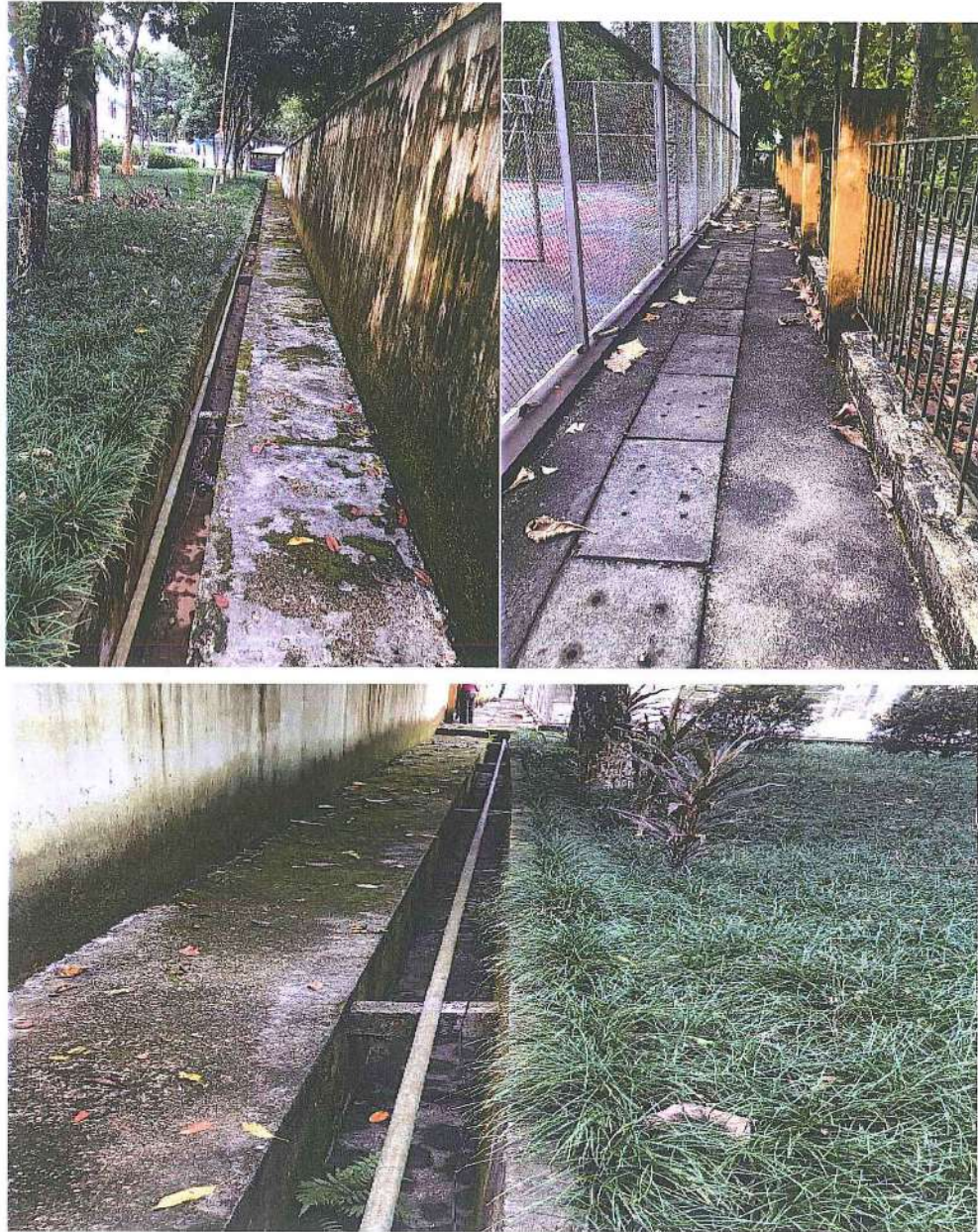
Hình 3.2. Hình ảnh hệ thống thu gom, thoát nước mưa xung quanh nhà điều hành
