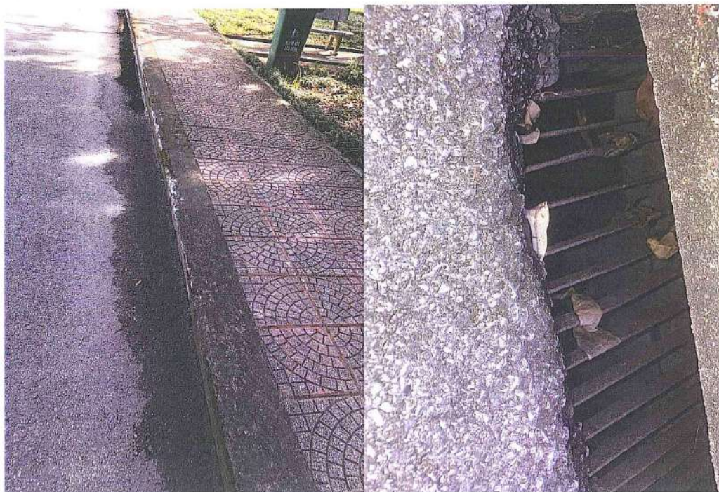
Hình 3.1. Ảnh chụp hệ thống thu gom, thoát nước mưa khu vực tuyến đường nội bộ nhà điều hành
