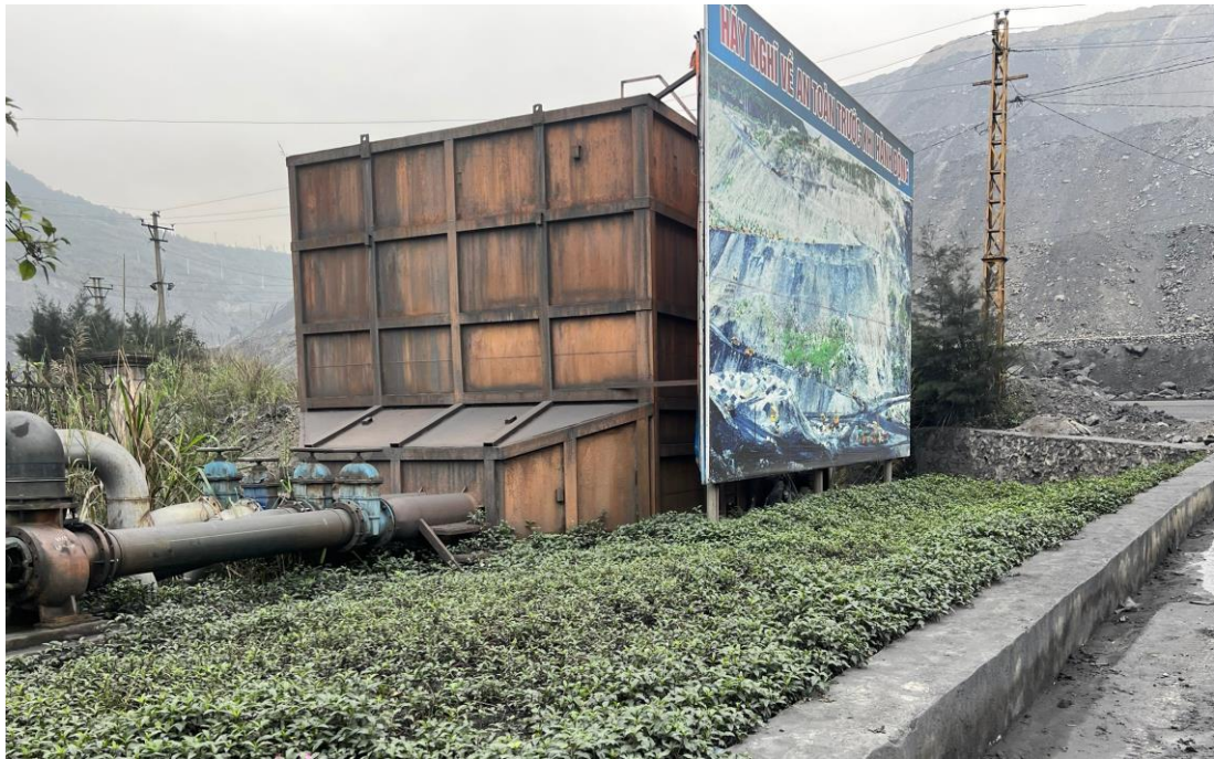
Hình 3. 7. Bể gom và hệ thống bơm tại mức +32 thuộc quản lý của Công ty Môi trường -TKV.
