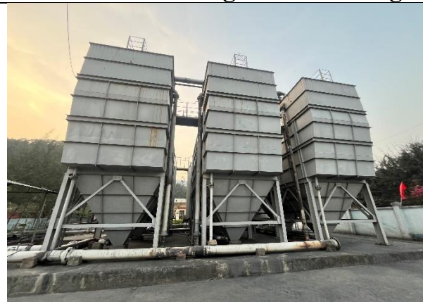
03 Thiết bị lắng lamella
