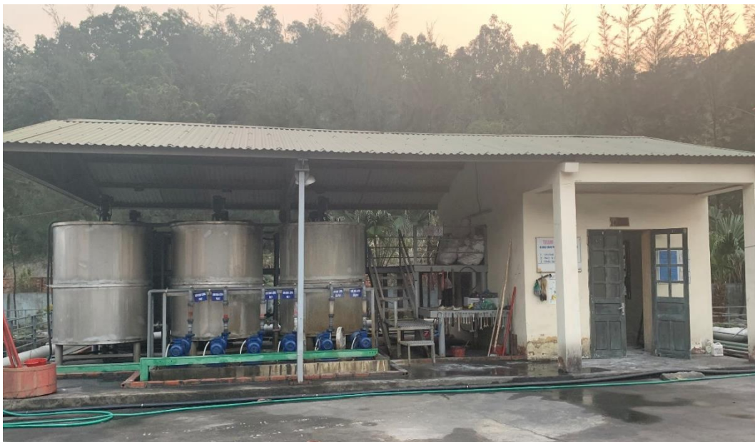
Hình 1. 9. Nhà che hóa chất và thiết bị
