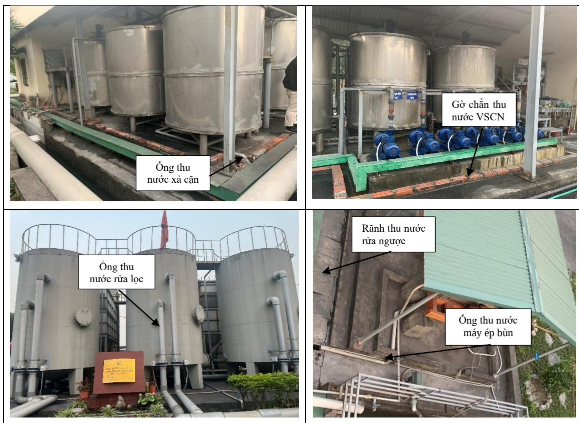
Hình 3. 9. Một số hình ảnh hệ thống thu gom nước thải trong trạm xử lý
