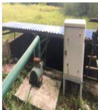
Bể thu gom
